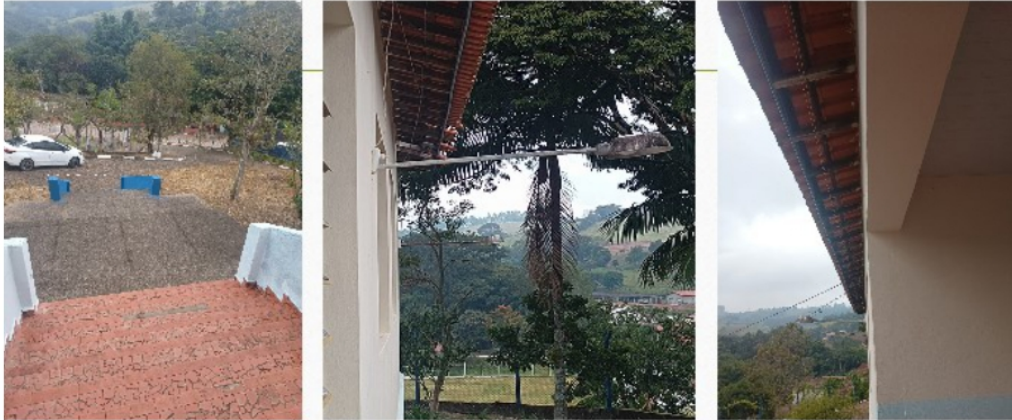
Entrada da escola – faltando pisos na escada e lâmpadas sem funcionamento (teto e subida da escola)
