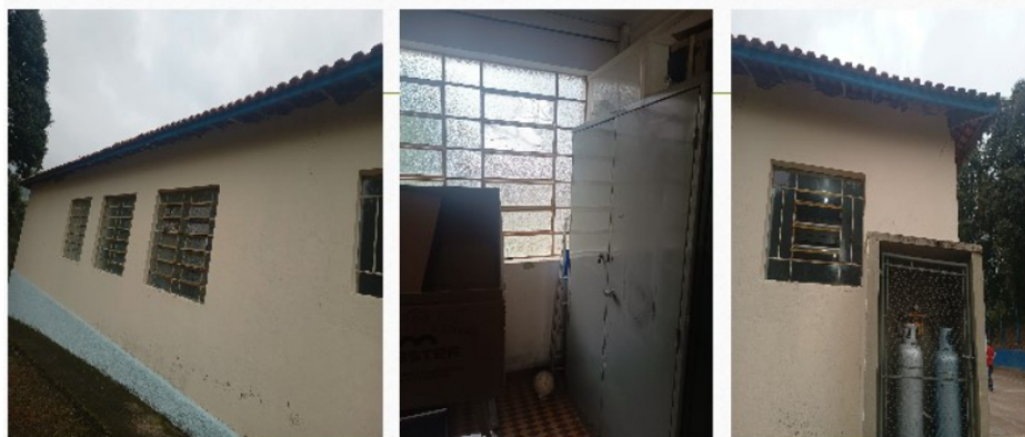
Vidro quebrado, pintura e pequenas rachaduras na parede
