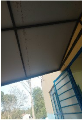
Toldo, portas com mal fechamento e vidro quebrado
