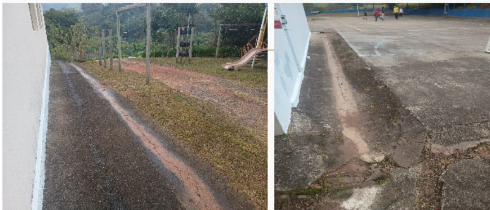
Buracos e desnível da entrada lateral
