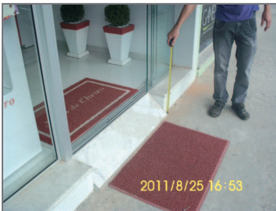
Exemplo de inclinação de rampa incorreta conforme os moldes de acessibilidade da NBR 9050
