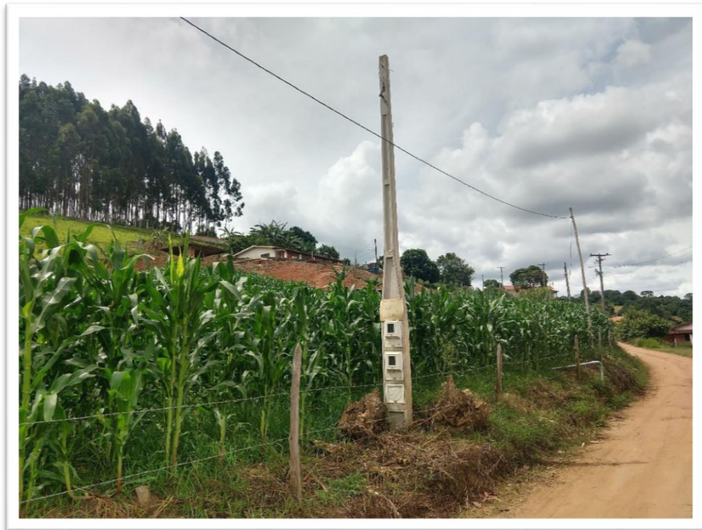
Figura 14 – Padrão de entrada de energia elétrica existente que está em conformidade com a concessionária. O suprimento de energia será acionado pela concessionária quando solicitada a mesma.
